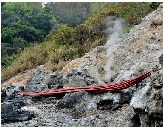
溫泉配管 Hot Spring piping
